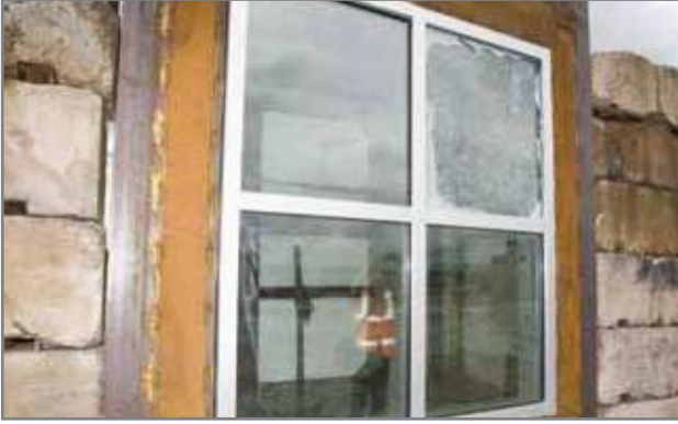
Patlamadan Sonra (Giydirme Cephesi)
